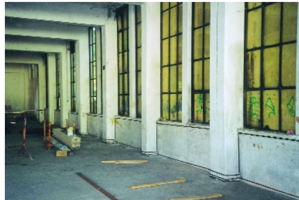
Abbildung 25: Alf Lechner Museum, Ingolstadt, Erdgeschoß Südwestwand mit Sockel- und Brüstungsheizrohren (Ø 18 mm) vor dem Aufputzen der Brüstungen und dem Anbetonieren des Sockelprofils.
