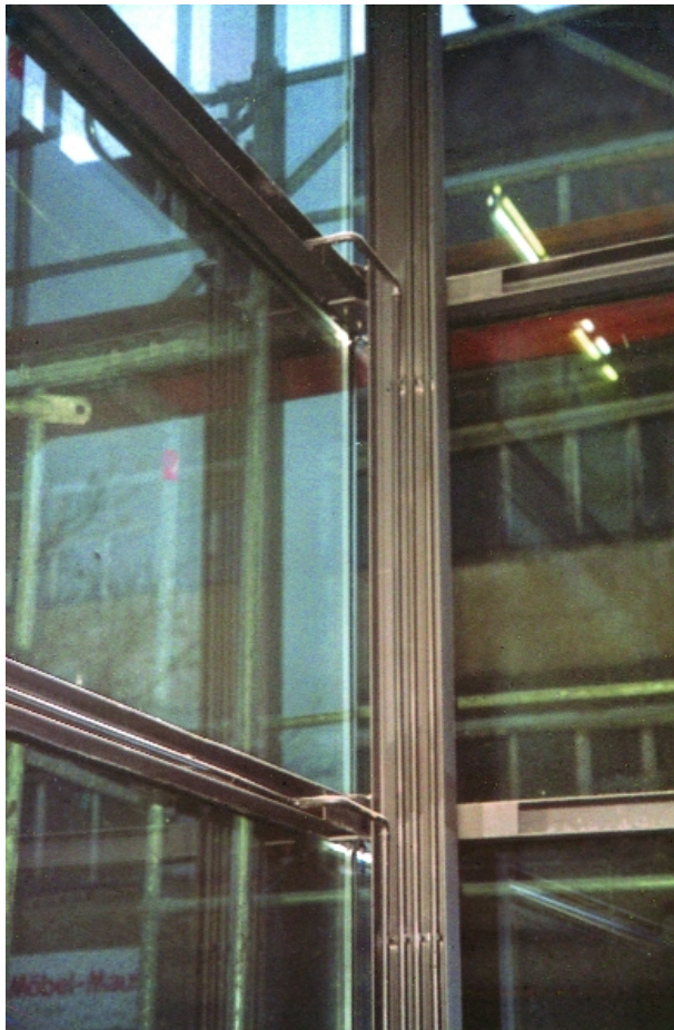
Abbildung 29: Alf Lechner Museum, Ingolstadt, Nordostecke des Glasvorbaus von innen Im Eckständer Zuleitungen zu den beiden Rohrschleifen der Fassade (Ø 18 mm) in Höhe der Geschosse (EG: 3. und 4., OG.: 6. und 7. Querprofil des Glashalteapparates). Alle Leitungen angestrichen und in Kunststoff- clips gehalten. Links Vorlauf (im unteren) und Rücklauf (im oberen U-Profil) der EG-Schleife.
